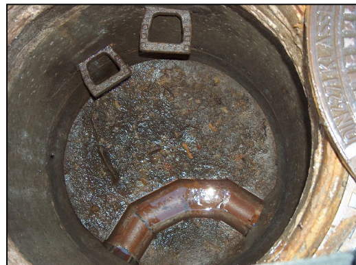
Abb. 5: Trittsiegel von Ratten im Kontrollschacht.
