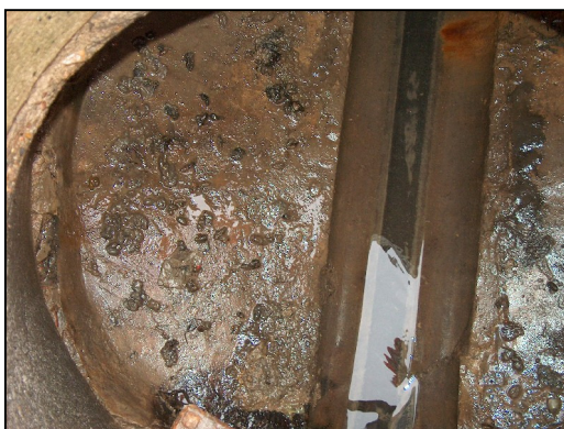
Abb. 6: Rattenlösung im Kontrollschacht (im Bild links auf dem Bankett).
